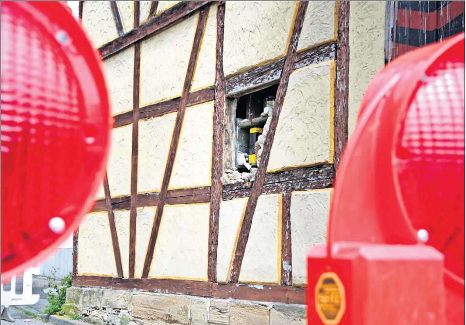
Der Zahn der Zeit hat die Fassade an dieser Stelle bröckeln lassen.
